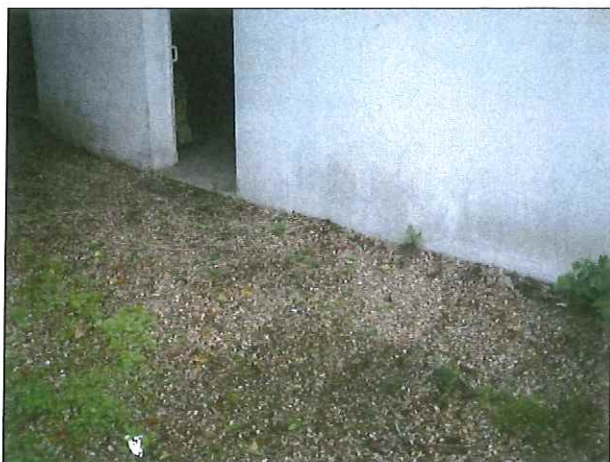
Sondage S1 à proximité du réservoir aérien de 3 m 3 FOD dans le sous-sol
