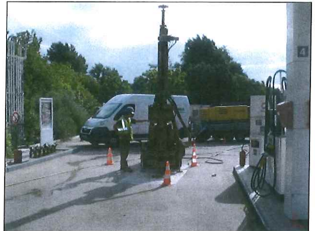
Sondage S7 localisé entre l'aire de dépotage et les volucompteurs VL
