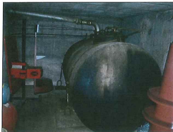
Vue du réservoir aérien de 3 m 3 FOD sur rétention béton dans le sous-sol
