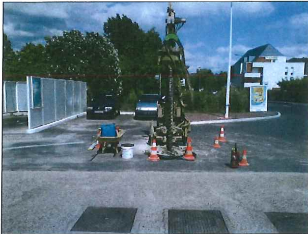
Sondage S12 à l'Est du réservoir multi-compartmenté (7) DE/PT de 80 m 3
